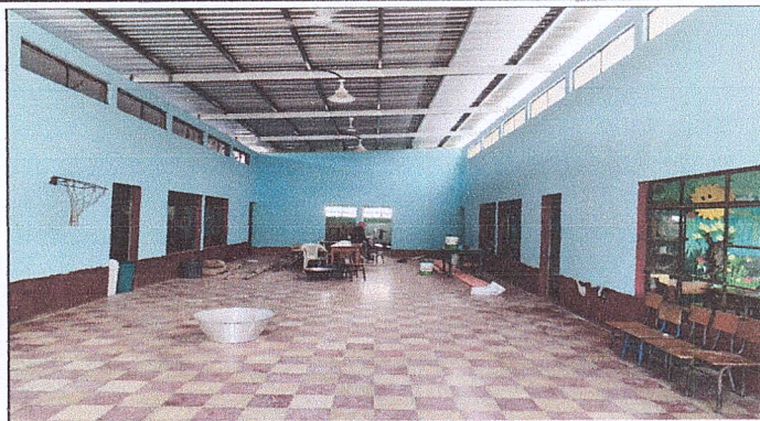
Pintura en muro interior
